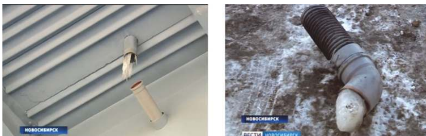
Рис. 21. Место отлома и упавшая деталь конструкции моста (2017 г.)
